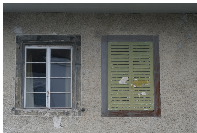
Die Illusionsmalerei auf der Südfassade im Vorzustand.
