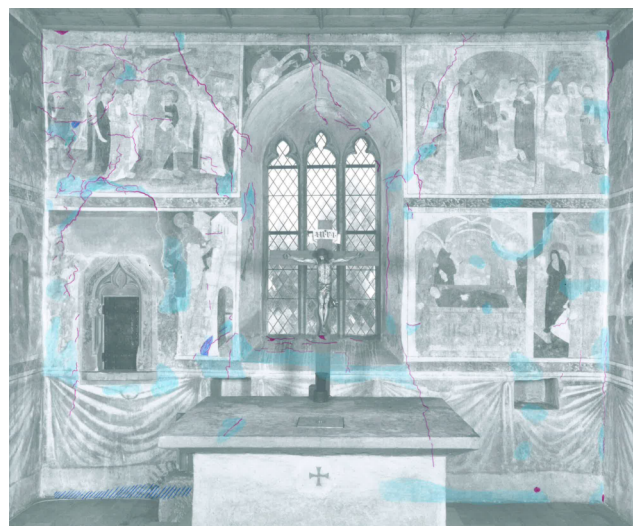
Schadenskartierung der Ostwand im Chor.
