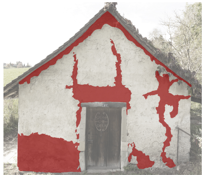
Visualisierung zementhaltiger/problematischer Ergänzungen an der Ostfassade des Waschküchens.
